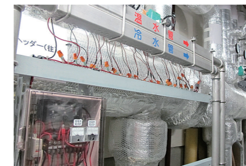
発電装置(薬師湯)
