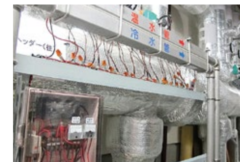
発電装置(薬師湯)
